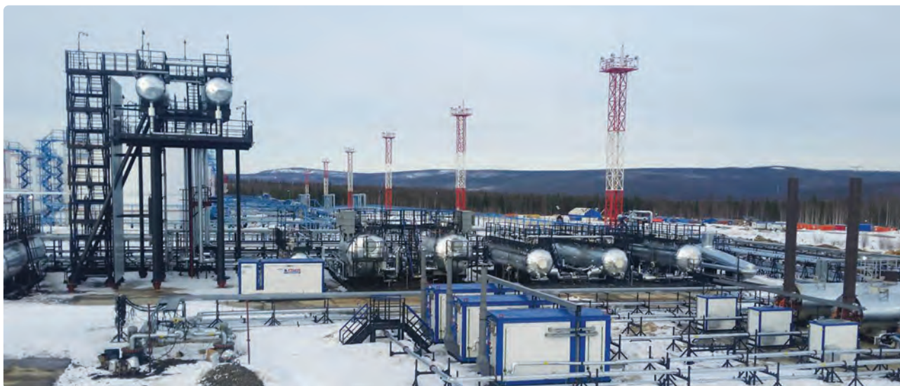
Рис. 1. МУПН-1500 на месторождении в Восточной Сибири
